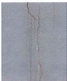
<外壁ヒビ割れ>
